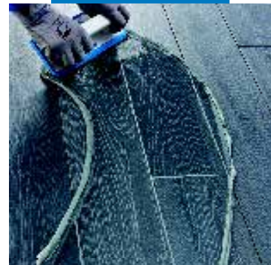
Заполнение с Kerapoxy Design пола из фарфоровой плитки под дерево с помощью резинового шпателя
